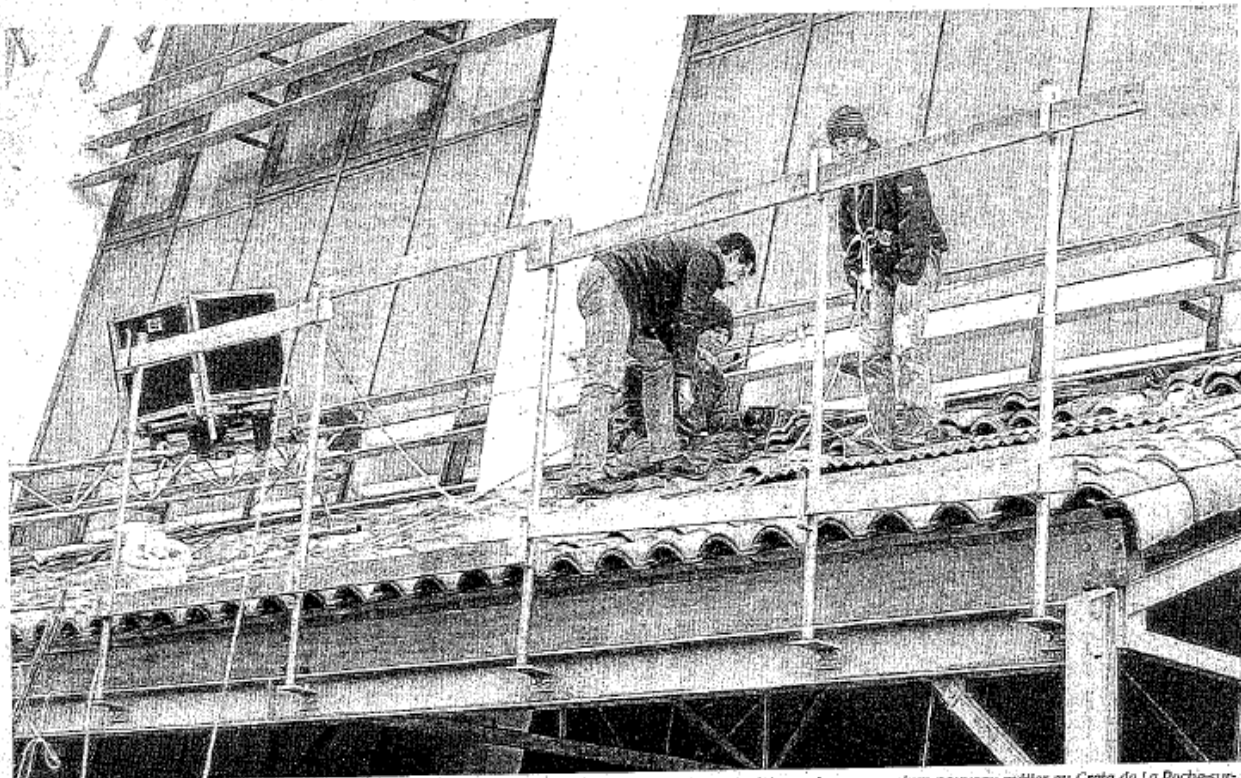
Vendée, sur un chantier. La formation professionnelle fait partie des actions d'une Région. Ici, des stagiaires qui apprennent un nouveau métier au Greta de La Roche-sur-Yon : ils vont devenir installateurs mainteneurs en équipements thermiques, solaires et photovoltaïques. Photo DR.
